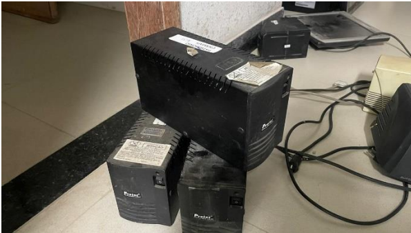
NOBREAK EM ESTADO RUIM
